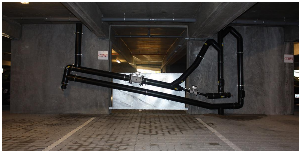
Figur 8.2: Flowmålersystem uden isolering og varmekabler.
