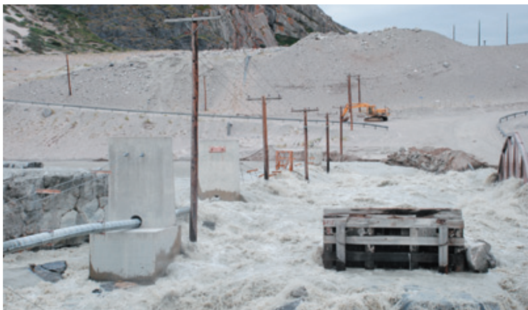
Figur 4a. Brusende smeltevand opstrøms broerne over Watson Floden (10. juli, 2012). Som det kan ses, er vandforsyningsledningen dækket af de voldsomme smeltevandsmasser. På figur 1 ses vandforsyningsledningen cirka 8–9 meter over den normale vandstand (Foto: A. Lyberth).
