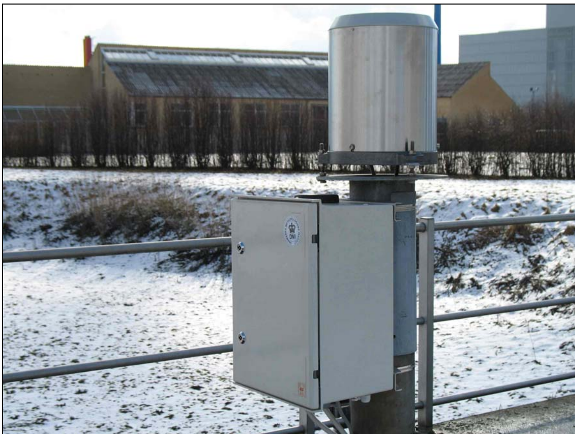
Figur 2. Styreskabet installeret i Næstved.
