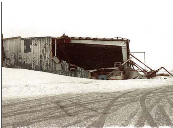
En voldsom føhn med mere end 100 knops vind blæste Iscentralens hangar i stykker i februar 1993. Det kostede 1.8 mill. kr at reparere og forstærke hangaren. Foto: Søren Larsen.
